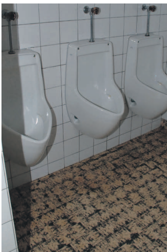
Die sanitären Anlagen wurden vor 40 Jahren erstellt und bedürfen einer Modernisierung.
