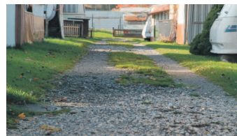
Erneuert werden müssen auch die internen Gehwege im westlichen Bereich.
