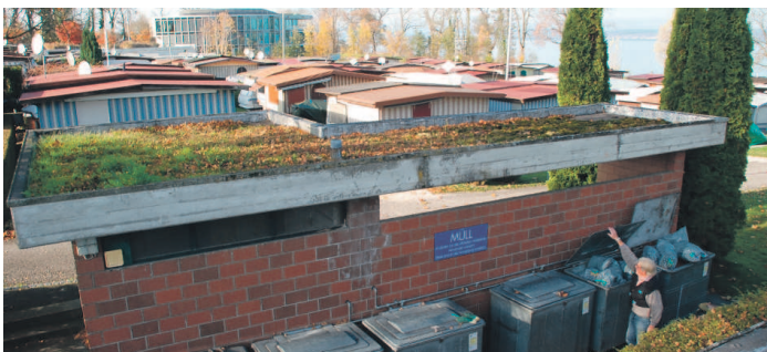
Der Gussasphalt auf den Dächern der Anlagen ist teilweise spröde und bedarf einer Sanierung. Ebenso müssen die Dächer neu begrünt werden.
